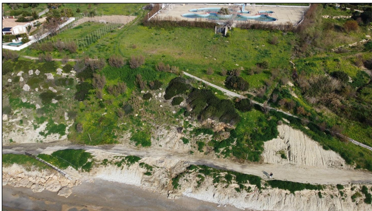
Figura 8 - Area in dissesto (vista da sud).
